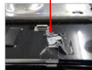
貼物を除去しないとねじが 露出しない一例
